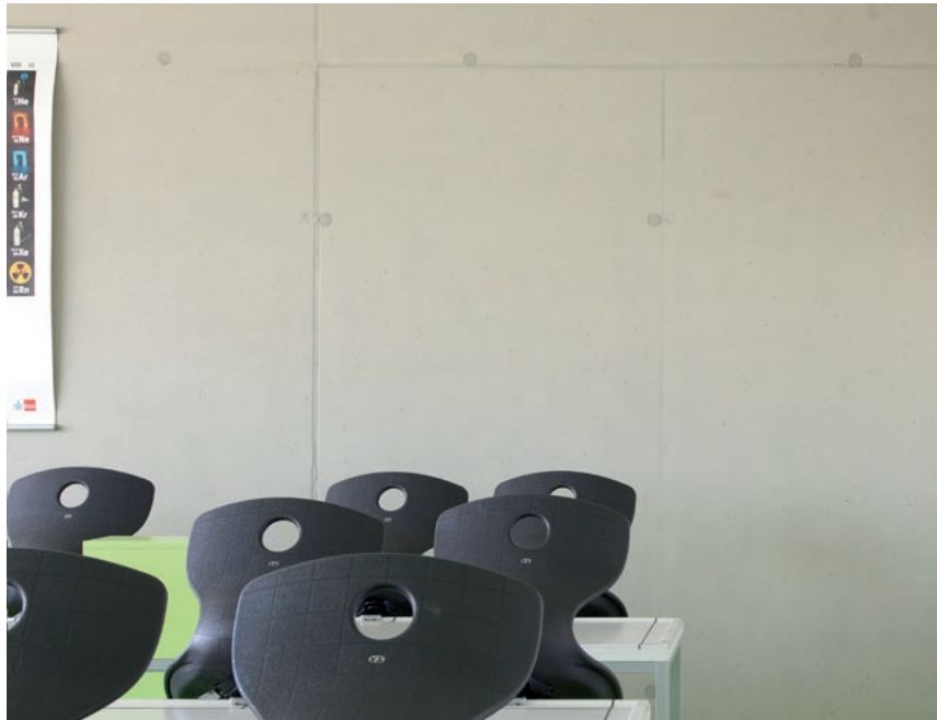
Die Systemschalung ist noch zu erkennen, doch die Sichtbetonwand überzeugt durch ihr homogenes Oberflächenbild.
